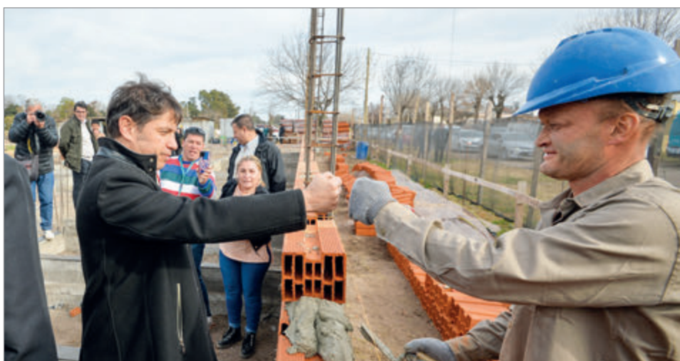
El gobernador recorrió los avances de las obras de construcción de un nuevo CAPS en Henderson
