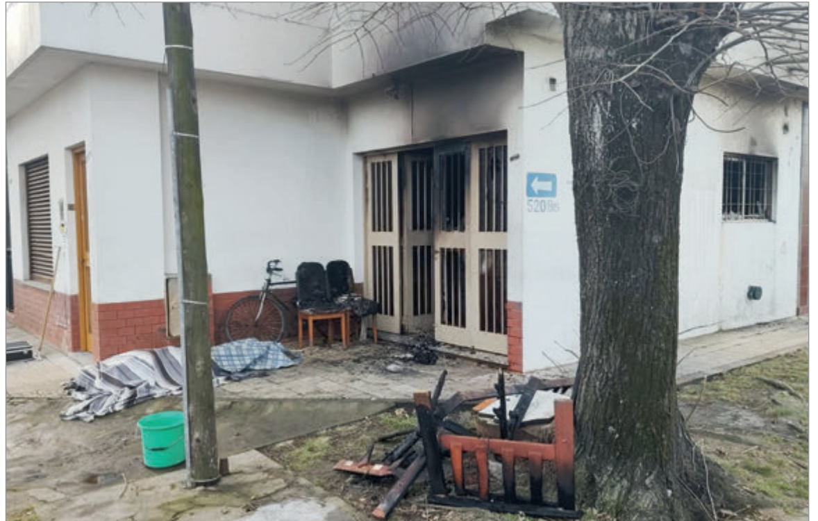
La vivienda incendiada
