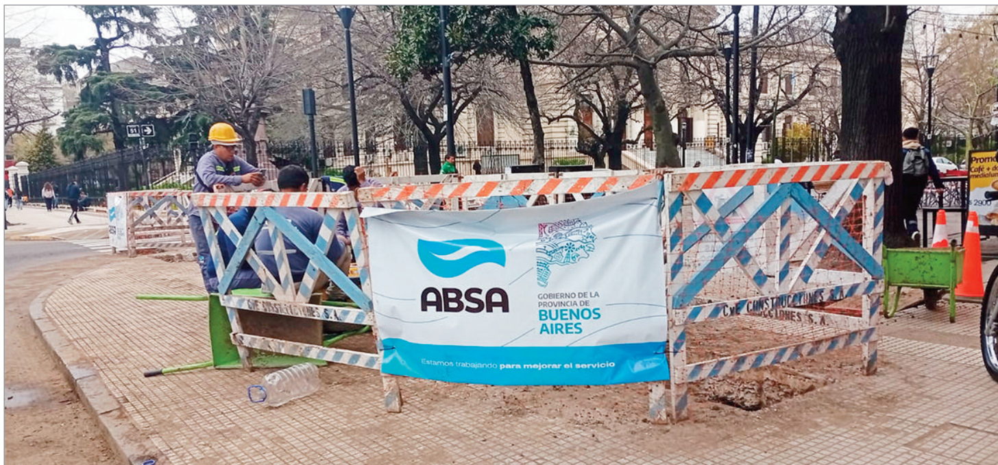
La rotura del caño en pleno centro
