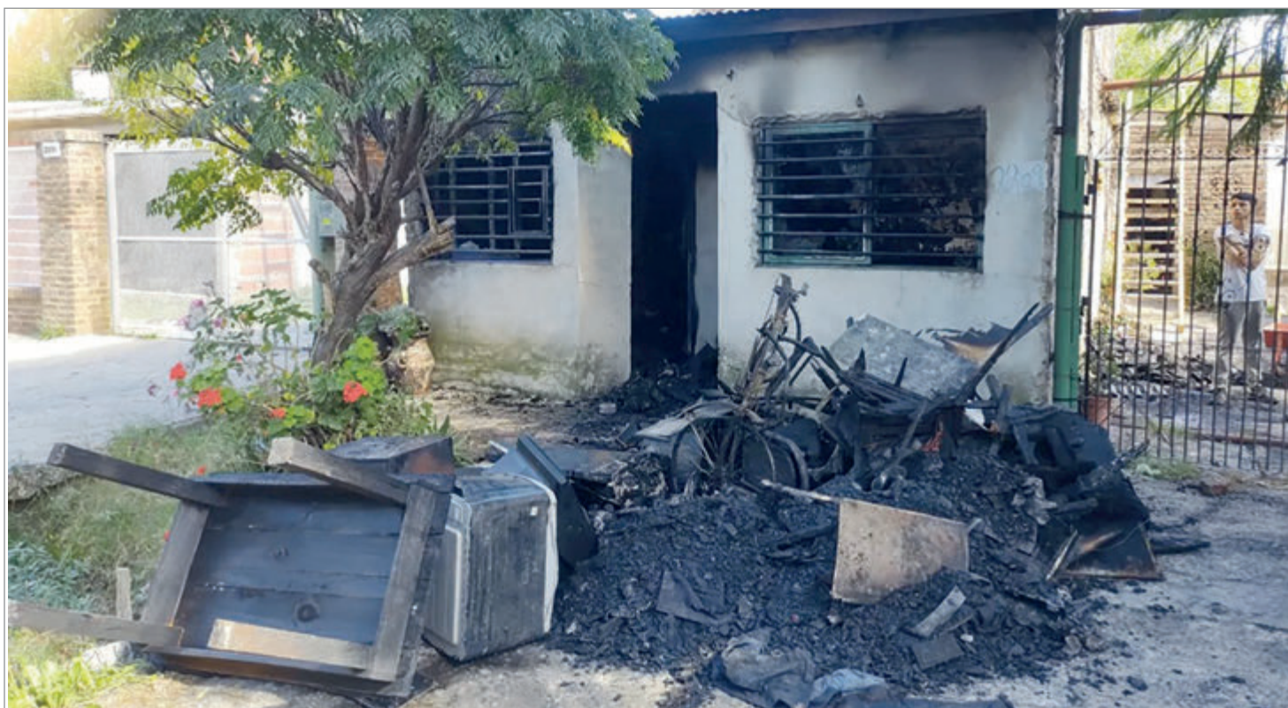
La vivienda incendiada
