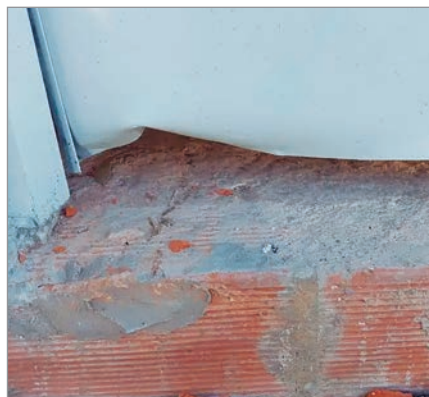
Parte de los daños
