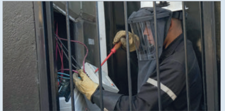
Durante las inspecciones se constató la manipulación de medidores
