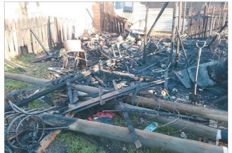
La casa quedó en ruinas
