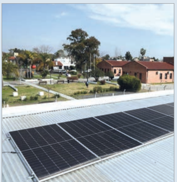
La instalación de 12 paneles solares permitirá reducir el consumo eléctrico
